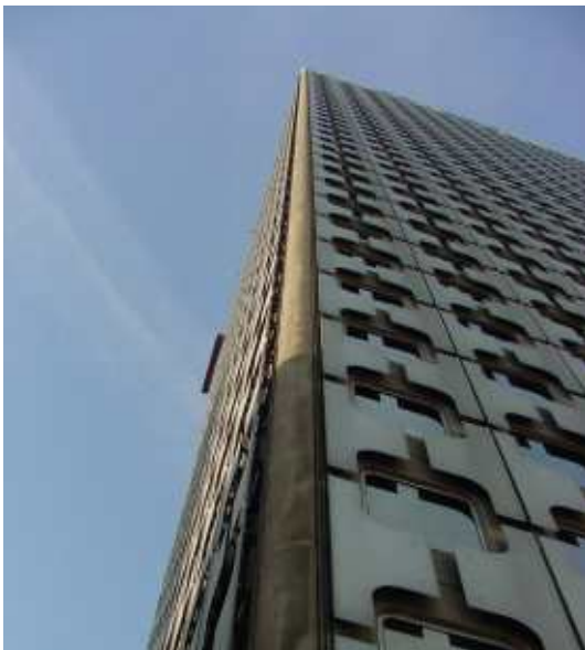
état préexistant : angles
